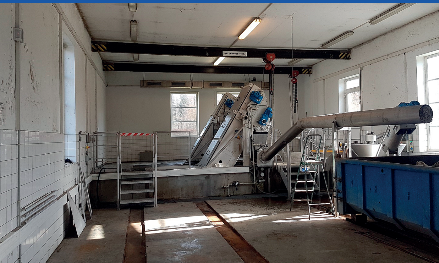
Nová strojní technologie hrubého předčištění na ČOV Šumperk.
